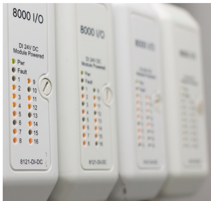
図1. 24Vプログラマブルロジックコントローラの入出力モジュール
